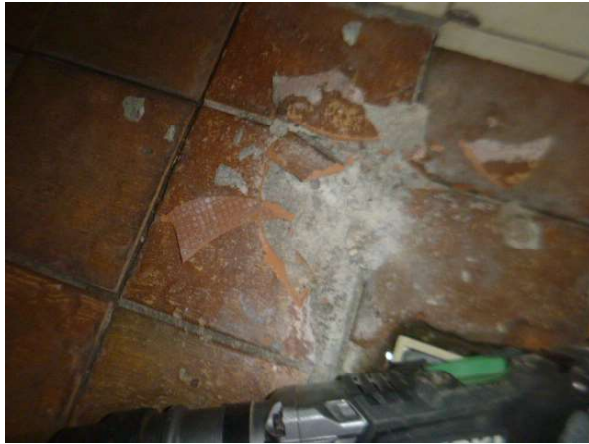
Tegels in cement
