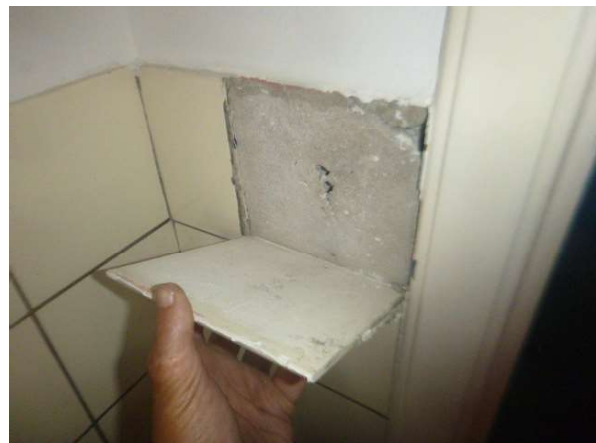
Tegels in cement
