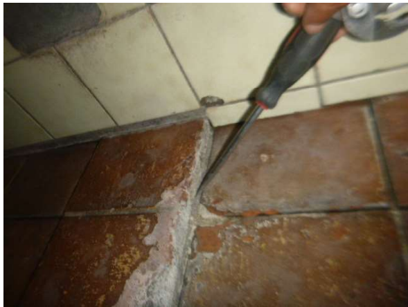
Tegels in cement
